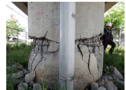
写真-7 段落し部の損傷 市道(1-3)中央線・中央線陸橋
