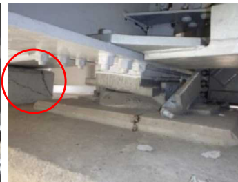
写真-6 支承の破損の状況
