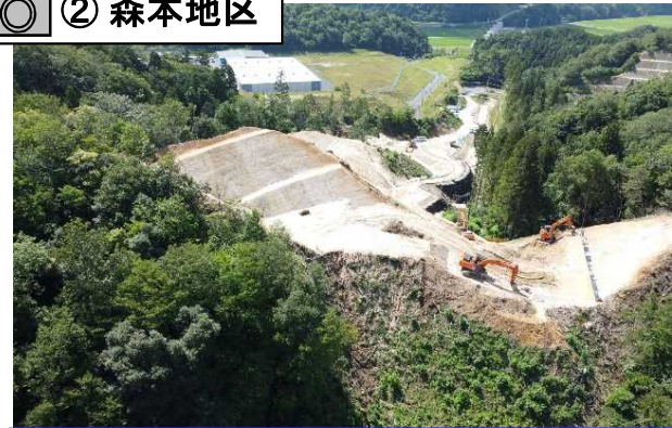
山を掘削して土砂を搬出し、工事用道路を造っています。
