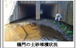
樋門の土砂堆積状況
