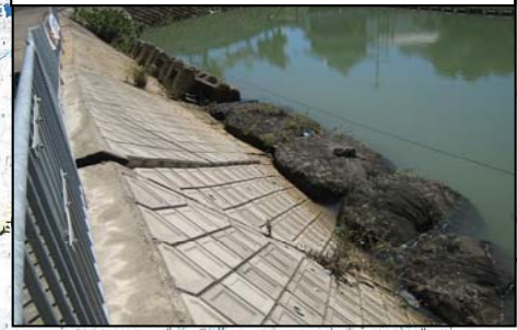
(番号6) 福知山市字堀 (法川排水機場) 漏水(護岸崩落) 約24m
