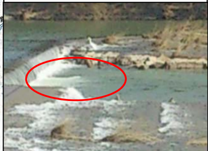
(番号12) 綾部市位田町 (栗村井堰) 床止損壊 約970㎡
