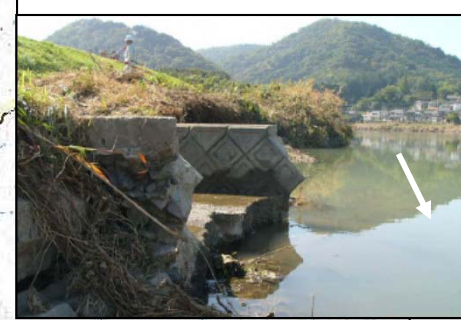
(番号13) 綾部市味方町 河岸崩壊 約144m
