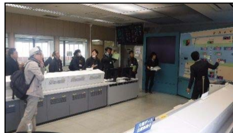
毛馬排水機場
