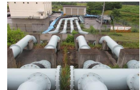
▲弘法川緊急排水ポンプ設備
