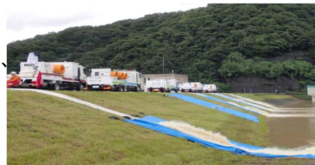
▲排水ポンプ車配置状況(荒河排水機場)
