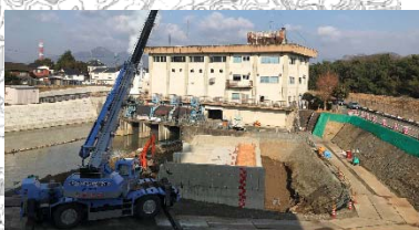
法川排水機場工事中 【能力】12m 3 /s
