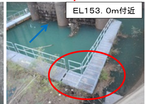
発電取水用除塵フロート
