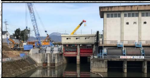
法川排水機場[国] 3m 3 /s緊急排水ポンプ増設
