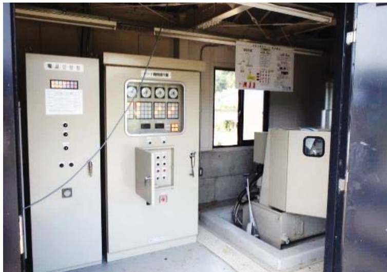
谷河川樋門(樋門操作室内)
