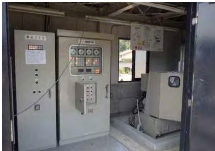
谷河川樋門(樋門操作室内)
