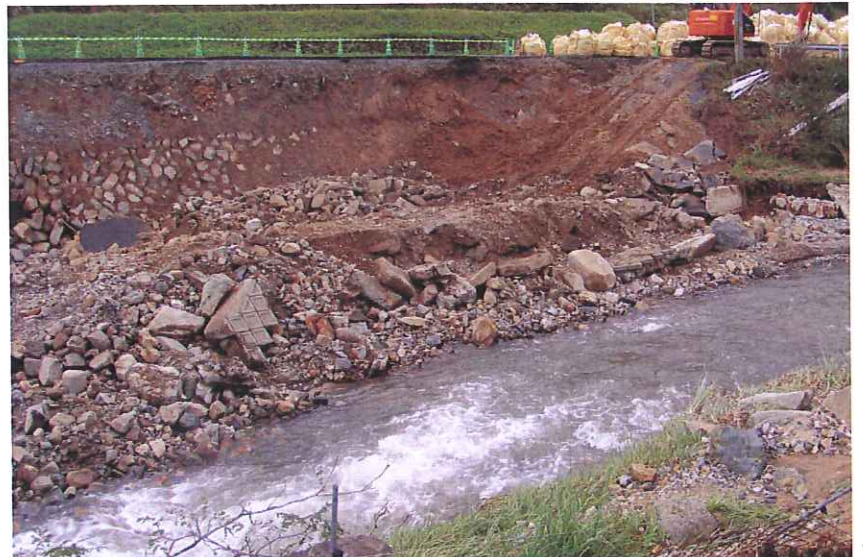
国道426号が崩落。通行不能となる。旧府道を拡張した部分が崩落し、旧道の石積みがそのまま姿を見せた(福知山市一ノ宮/佐々木川)
