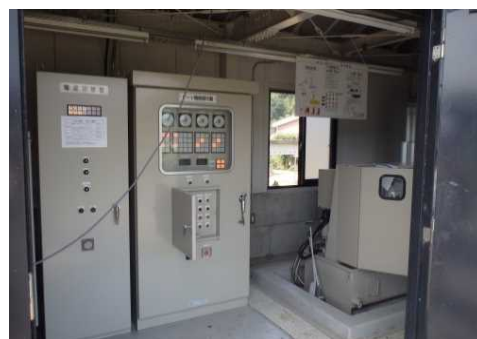
谷河川樋門(樋門操作室内)
