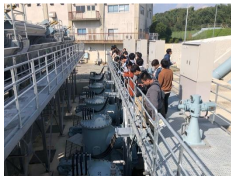
▲法川排水機場
