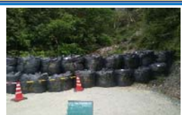
梅雨に入り、現場からの土砂等の流出を防ぐため、大型土嚢を設置しました。
