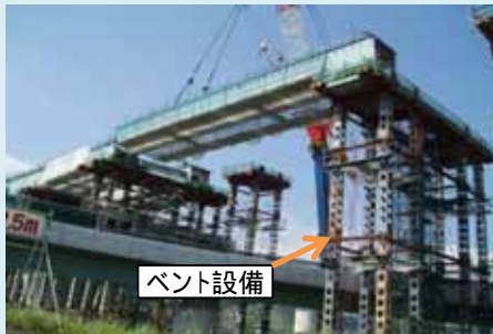
ベント設備(当社施工事例)
