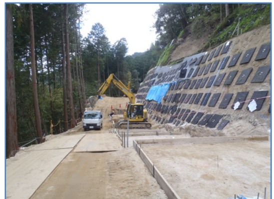
付替県道現況写真(10月15日) (No.121付近) 5号補強土壁の基礎工を施工しています。
