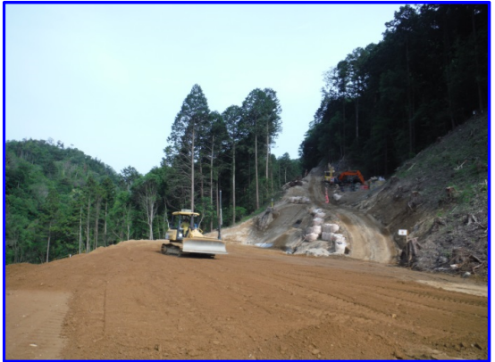
付替県道現況写真(6月14日) (No.115付近) 搬入土により高盛土部の盛土を施工しています。
