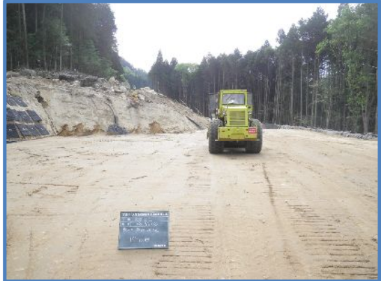
付替県道現況写真(5月14日) (No.115付近) 搬入土により高盛土部の盛土を施工しています。
