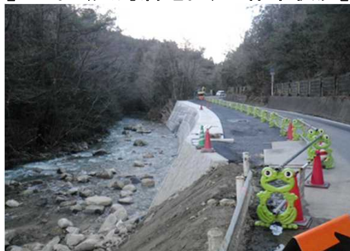
(左の写真) 護岸部分が 完成し、アス ファルト舗装 の準備をして います。
