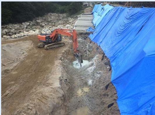
1号補強土壁掘削、岩盤破碎状況
