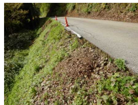
路肩欠損の状況
