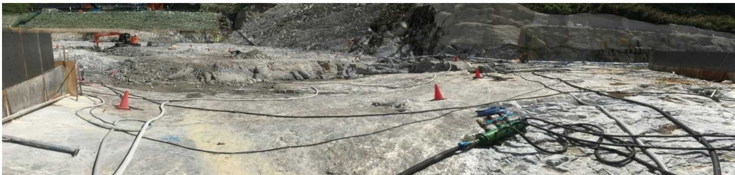
低角度割れ目(掘削後)
