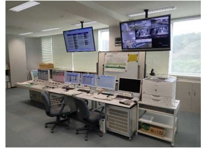
ダム管理用制御処理設備工事(比奈知ダム)
