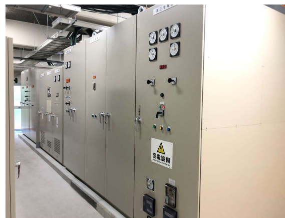
高圧受変電設備
