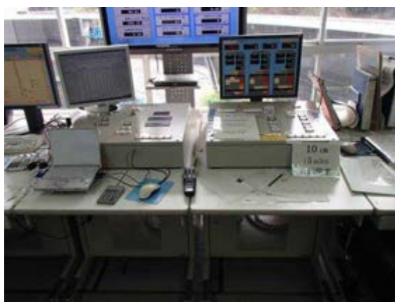
遠方手動操作装置(既設)
