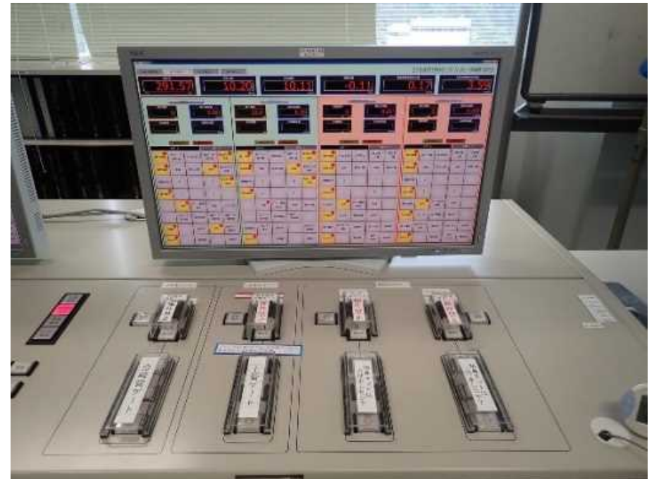
ダム管理用制御処理設備イメージ(比奈知ダム)
