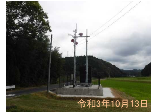
放流警報設備
