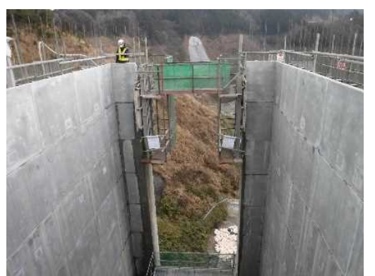
取水設備(取水塔側面部)
