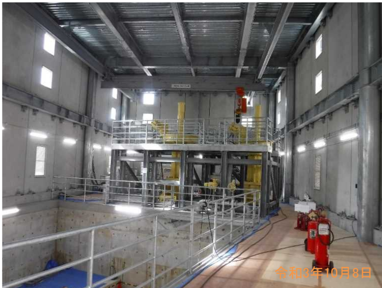
主管ゲート・主副ゲート設置状況
