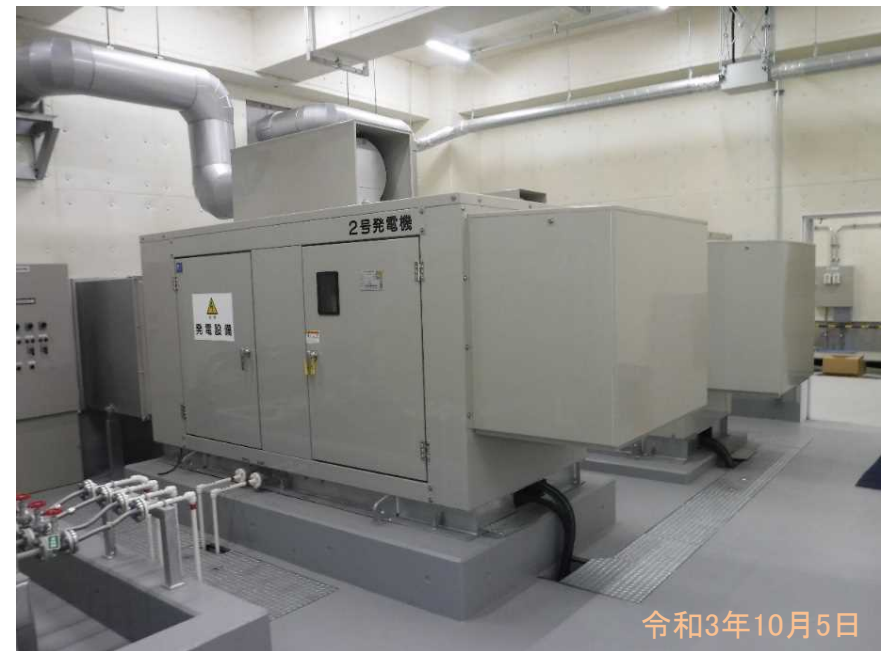
予備発電設備設置状況
