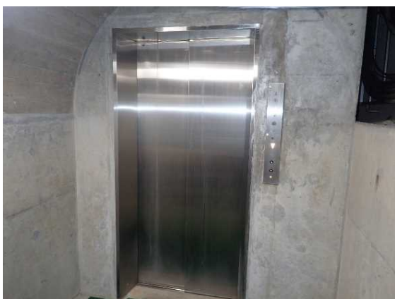
エレベータイメージ(布目ダム)
