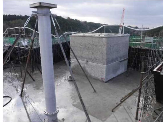
エレベータシャフト
