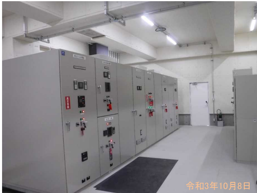
受変電設備設置状況
