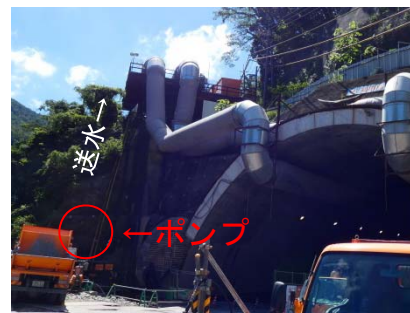
▲送水ポンプ設備
