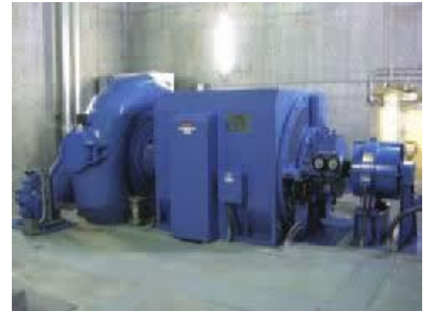
片輪水車の事例 (日吉ダム)
