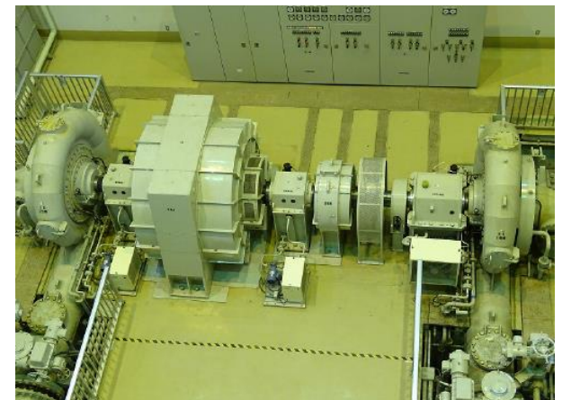
両掛水車の事例 (奥木曾発電所(味噌川ダム))
