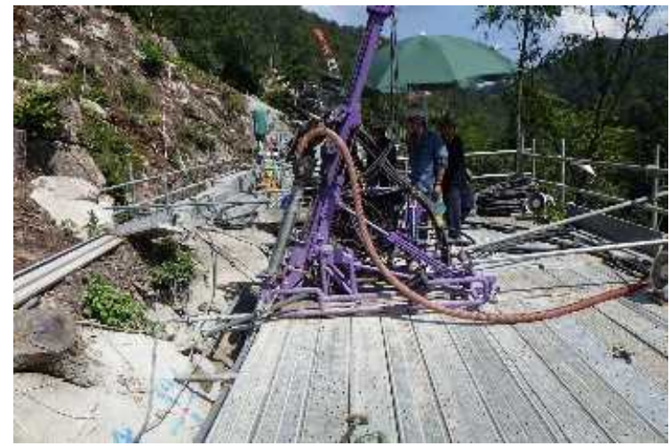
地山にそのままコンクリート基礎部分を支える アンカーを打ち込む→地山改変量を抑制
