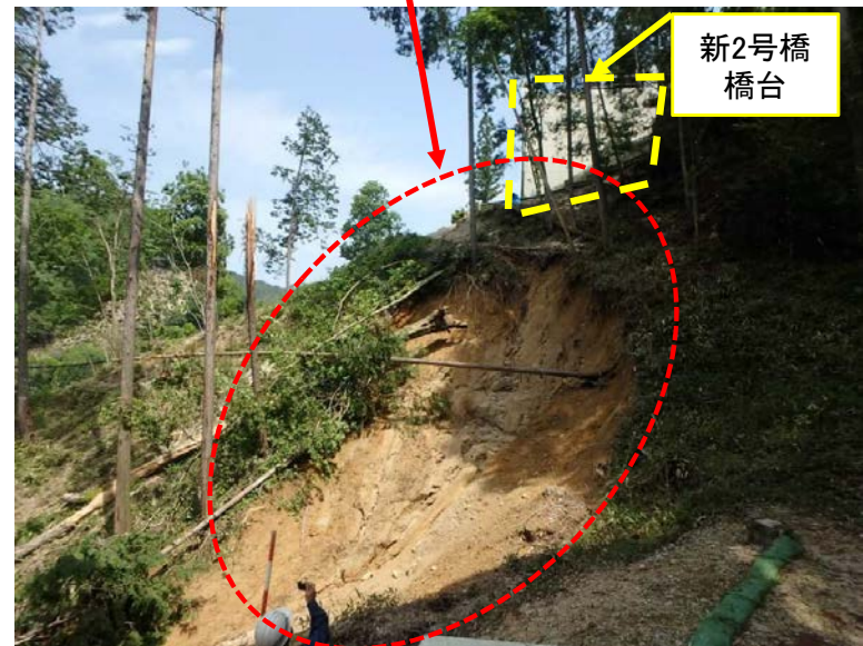
新2号橋 橋台付近の土砂崩落(発生直後)
