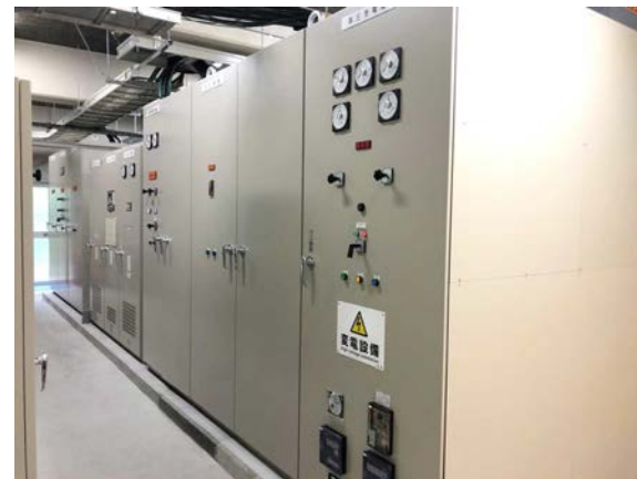
高圧受変電設備
