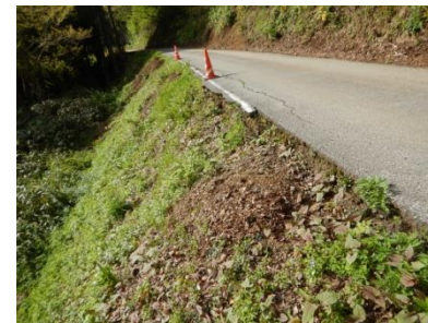
路肩欠損の状況
