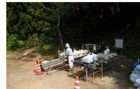
モノレール(立坑閉塞)
