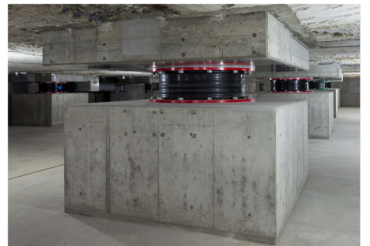
免震装置（鉛プラグ入り積層ゴムアイソレーター）
