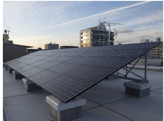
屋上 (太陽光発電パネル)
