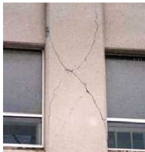
柱のひび割れ
