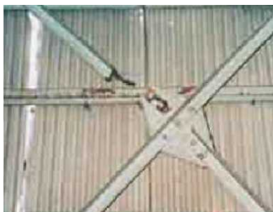
筋交いの大きな変形・破断
