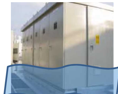
受変電設備等の浸水
