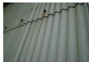
石綿スレート
