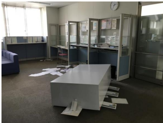
キャビネットの転倒事例① (床・壁非固定)
