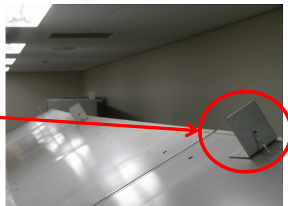
キャビネットの転倒事例③-2 (左のキャビネットの天板面の写真) (キャビネットと石こうボード壁面を留め付ける際に専用のビスが用いられず、ビスが壁面から抜けた状況)
