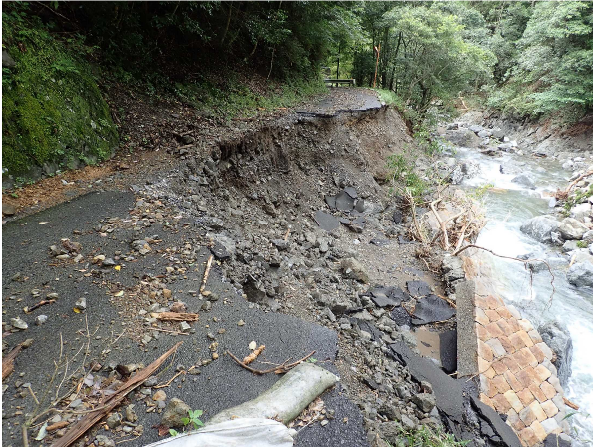
7/25【河川班】被害状況調査(芦北町)
