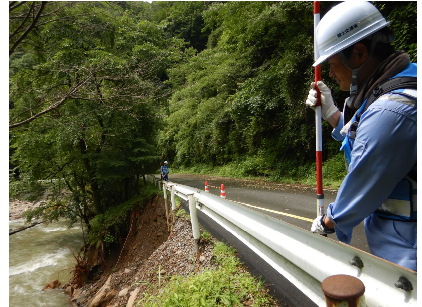
7/25【河川班】被害状況調査(多良木町)
