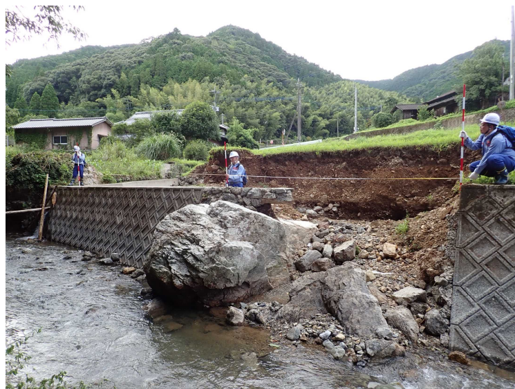
7/23【河川班】被害状況調査(芦北町)
