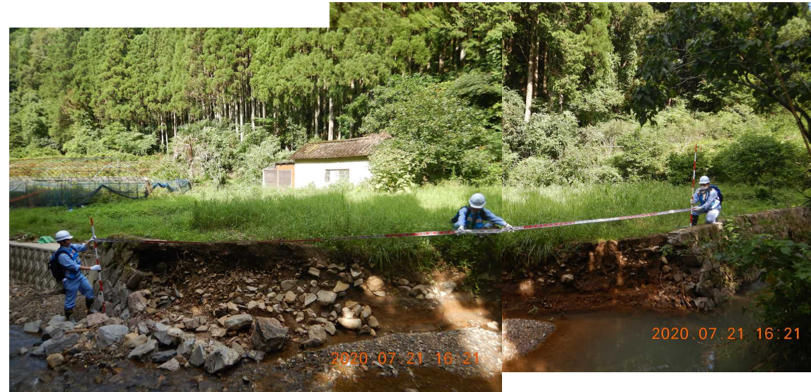
7/21【河川班】被害状況調査(芦北町)
