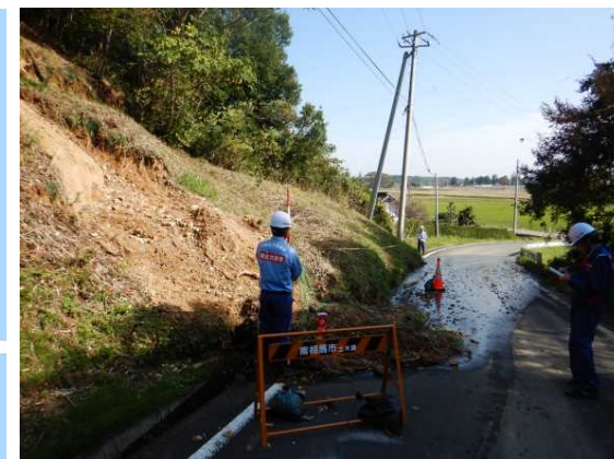
■10/31 道路被災状況調査 (福島県南相馬市)
