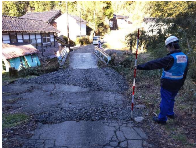
【道路班】輪島市 被災状況調査（18日）
