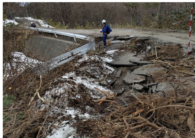
【道路班】輪島市 被災状況調査（15日）
