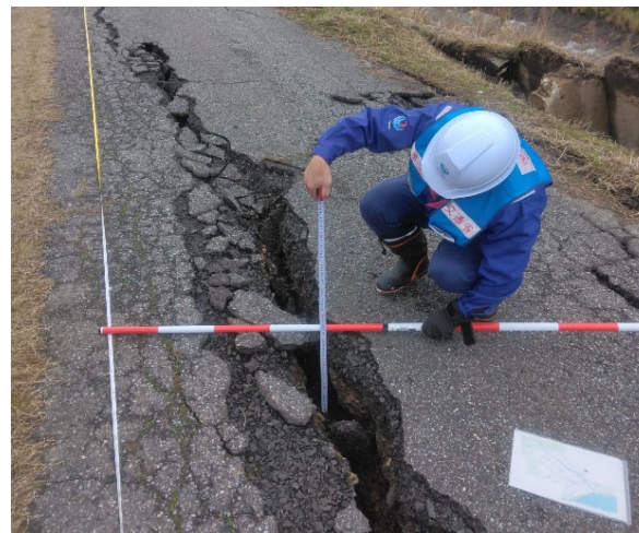
【道路班】輪島市 被災状況調査（6日）
