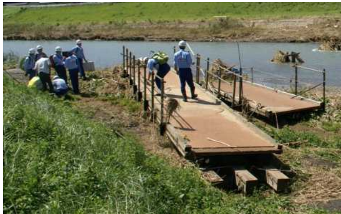
流出した境谷橋の調査
