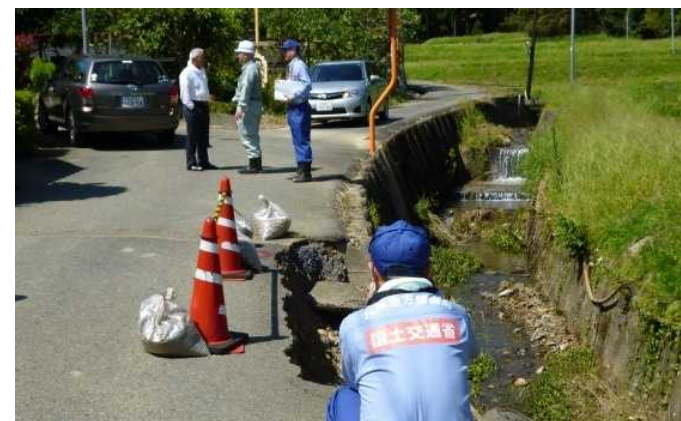
水路護岸の被災箇所の調査
