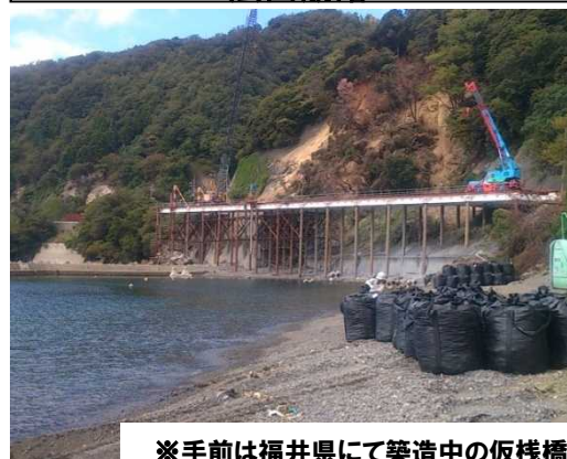
常神三方線 みかたかみなか わかさちようゆうし (福井県三方上中郡若狭町遊子) 法面崩落
