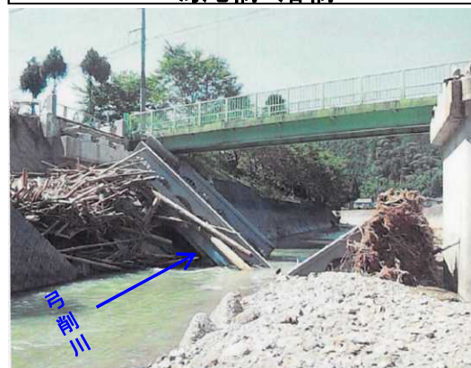
一般国道162号 けいほくしもゆげ (京都市右京区京北下弓削町) 鳴滝橋 落橋
