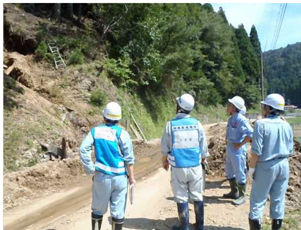
道路法面崩落箇所の調査(高島市今津地区)
