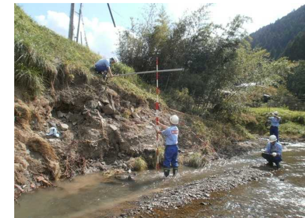
河川被災箇所の調査(南丹市中世木地区)
