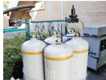
図3 移動式ガス発生設備
