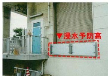
写真 2.1.1 住之江下水処理場の耐水化事例
