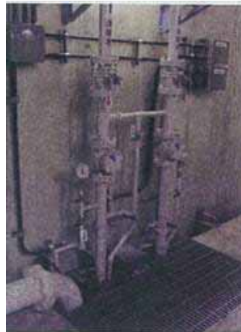
B2 排水ポンプ
