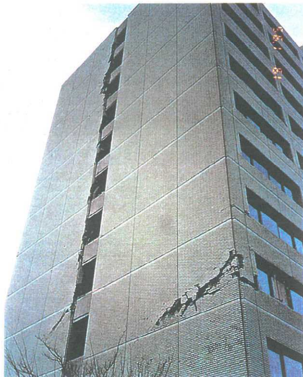
写真－14 神戸第2地方合同庁舎の破損（神戸市中央区）
