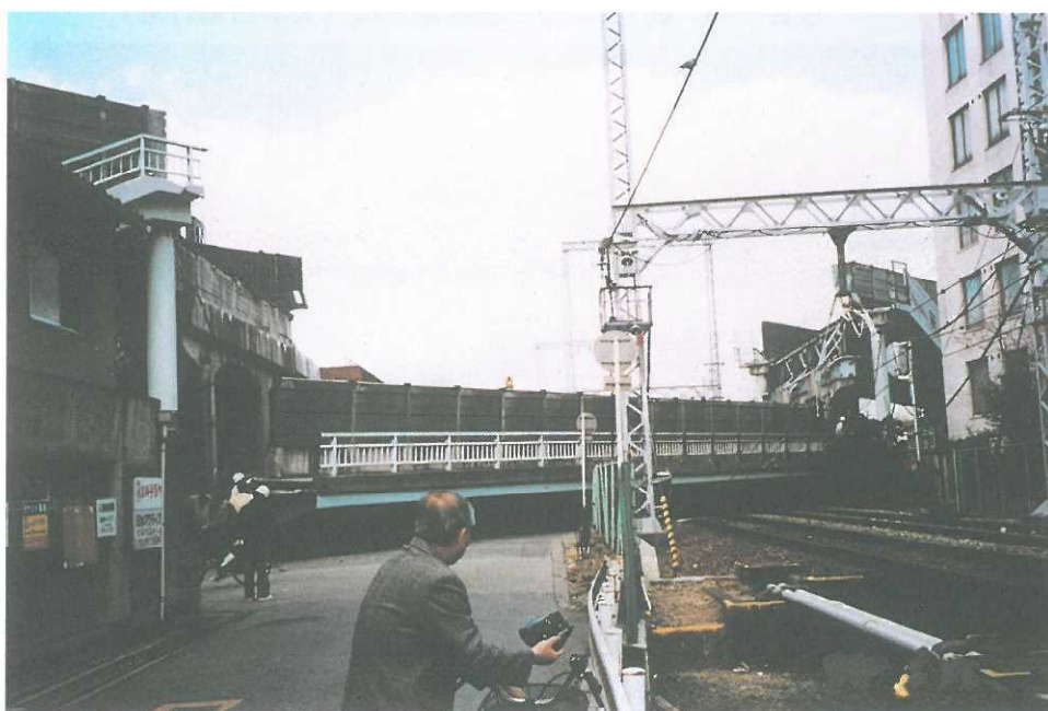
写真- 5 国道171号門戸高架橋の上部工、阪急電鉄今津線上に落下
