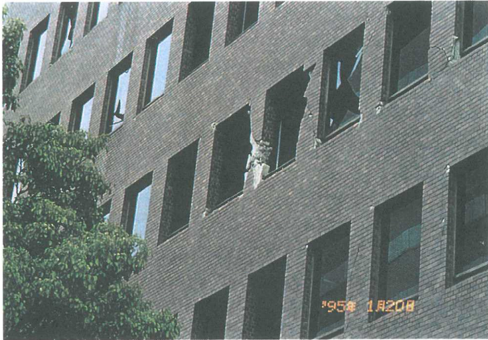
写真-25 神戸地方合同庁舎の破損状況
