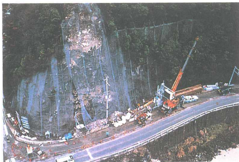
写真一 6 国道176号法面崩壊状況（大多田橋付近）
