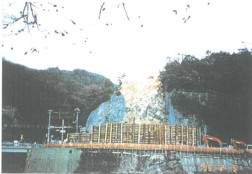
写真 - 11 国道 176号崩落法面応急復旧状況（平成 7 年 2 月 5 日）
