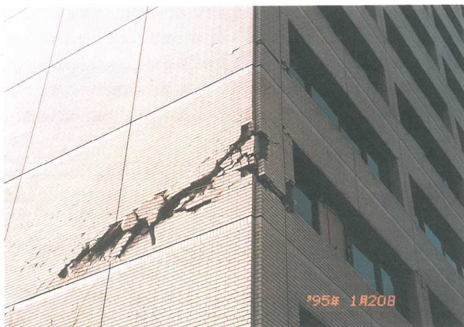
写真-27 神戸第2地方合同庁舎の破損状況
