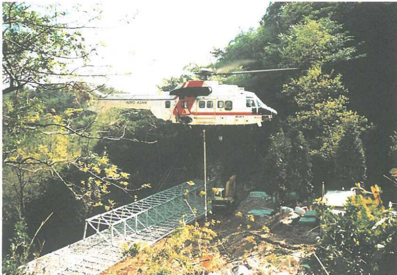
写真-23 ヘリコプターによる緊急砂防ダムの施工（渦ヶ森鋼製枠堰堤）
