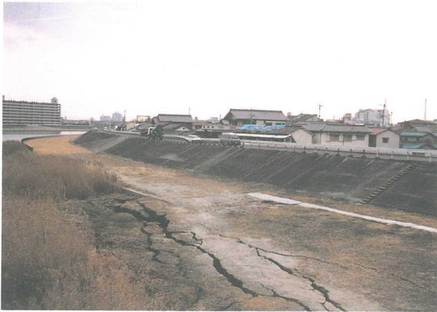
写真-20 猪名川（藻川）高田地区の被災状況
