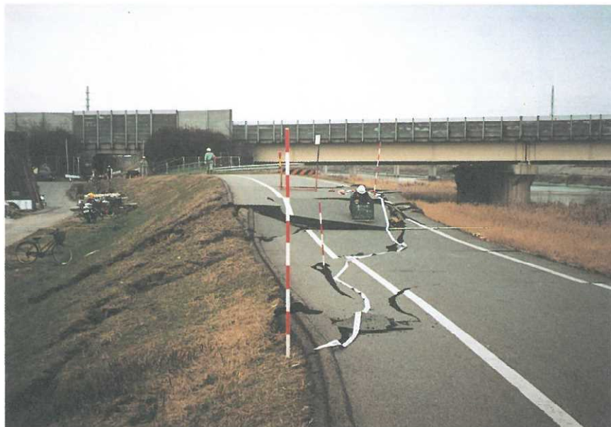
写真－11 猪名川（藻川）下流右岸堤防の陥没（尼崎市額田町地先）
