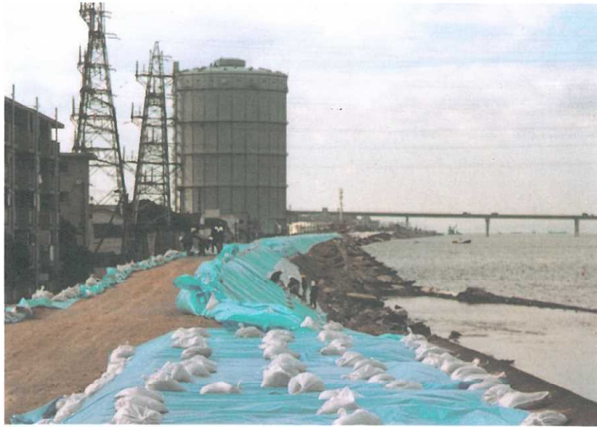
写真－10 淀川下流左岸堤防の陥没（大阪市此花区酉島）
