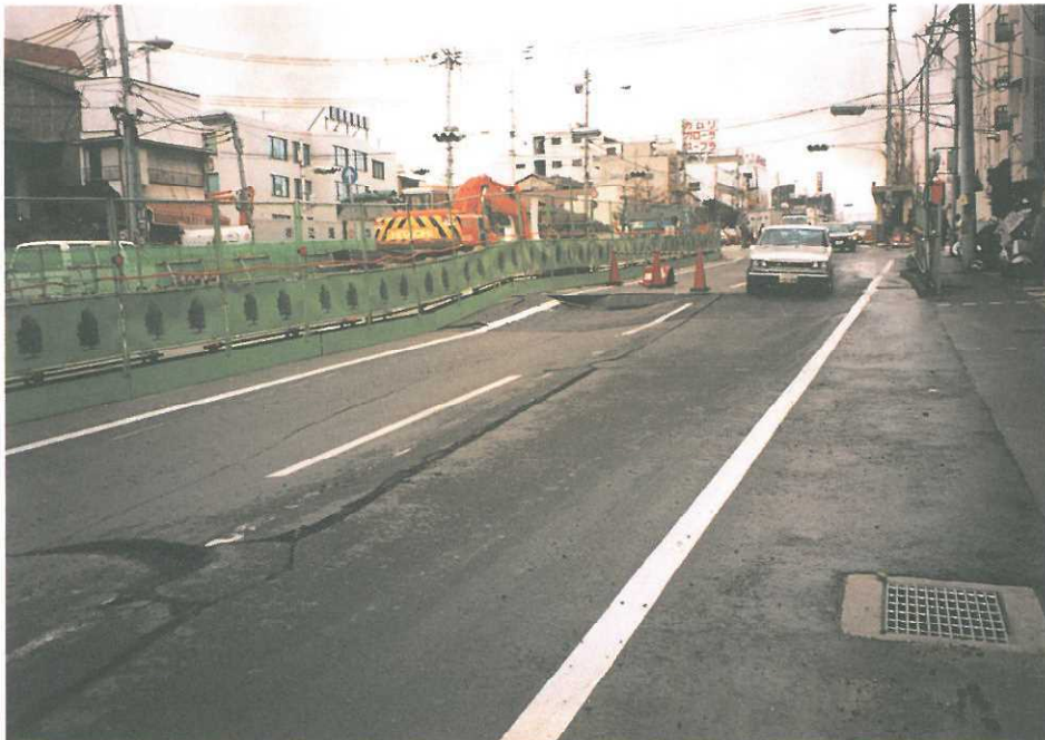
写真-8 国道2号の段差（神戸市東灘区）
