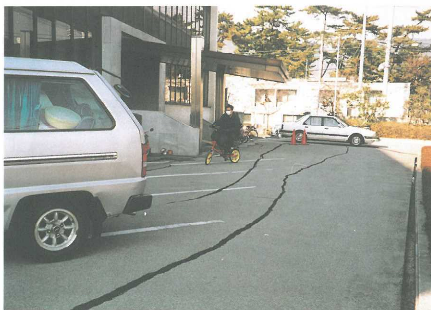
写真 - 1 阪神国道工事事務所構内アスファルト舗装の亀裂
