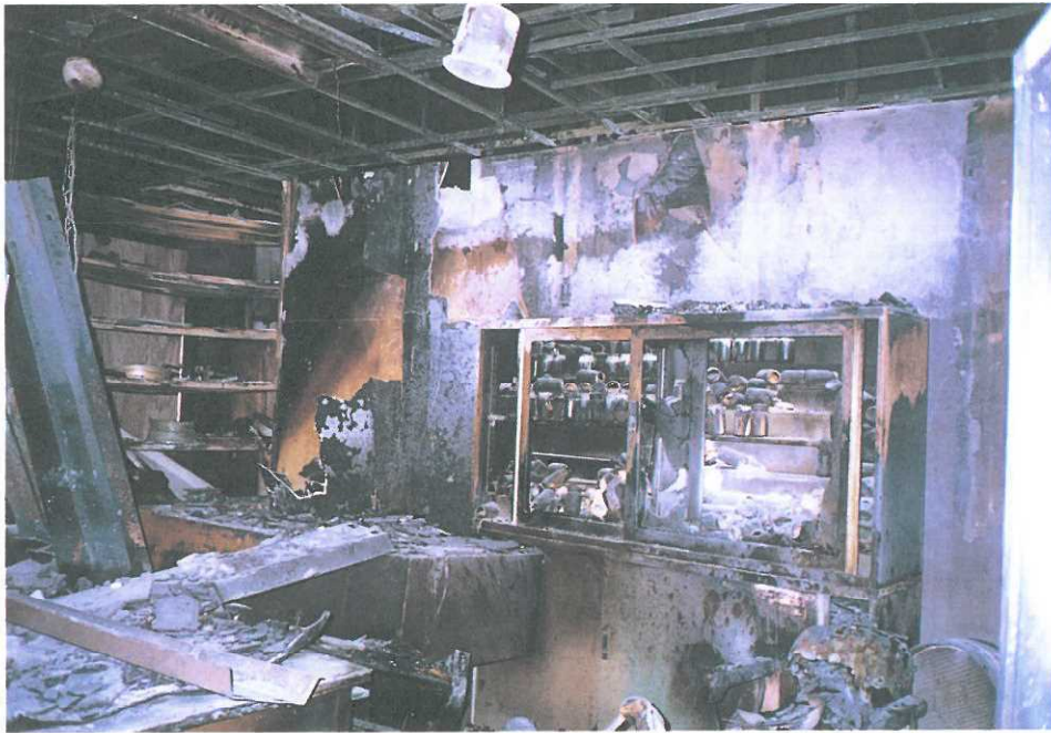
写真-26 神戸地方合同庁舎の焼失跡
