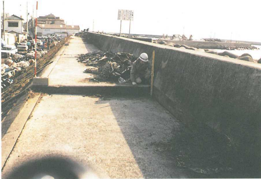
写真-12 東播海岸堤防の沈下（明石市大観町地先）
