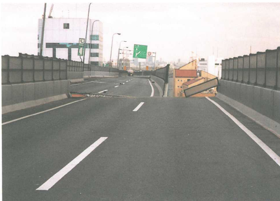
写真-9 国道2号浜手バイパスの桁ずれ（神戸市中央区）
