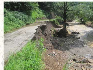
No.49 路肩欠損
