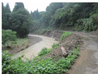
No.81 路肩欠損 五位谷橋 L=21.3 W=8.0
