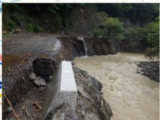
No.21 路肩欠損
