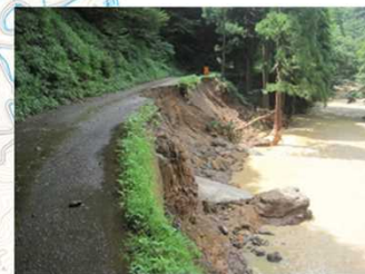
No.54 路肩欠損
