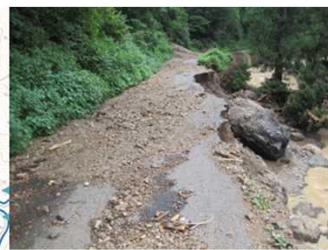
No.60-62 路肩欠損
