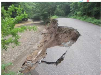
No.75 路肩欠損
