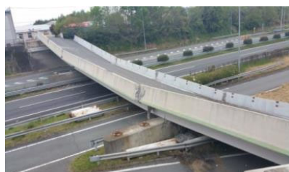
<緊急輸送道路上の橋梁の崩落>
